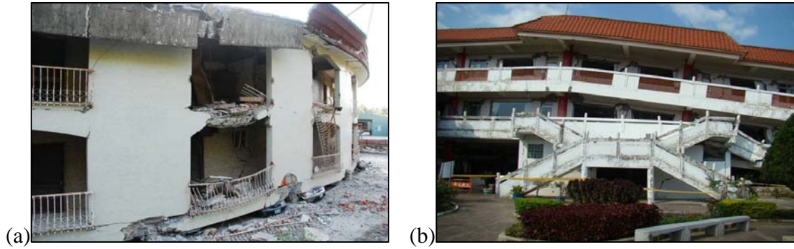
圖 2-2 (a)臺南新化球場旁三層樓建物，因下方樑柱斷裂倒塌 (b) 高雄縣內門紫竹寺活動中心因一樓倒塌而傾倒 (國家地震工程研究中心)
