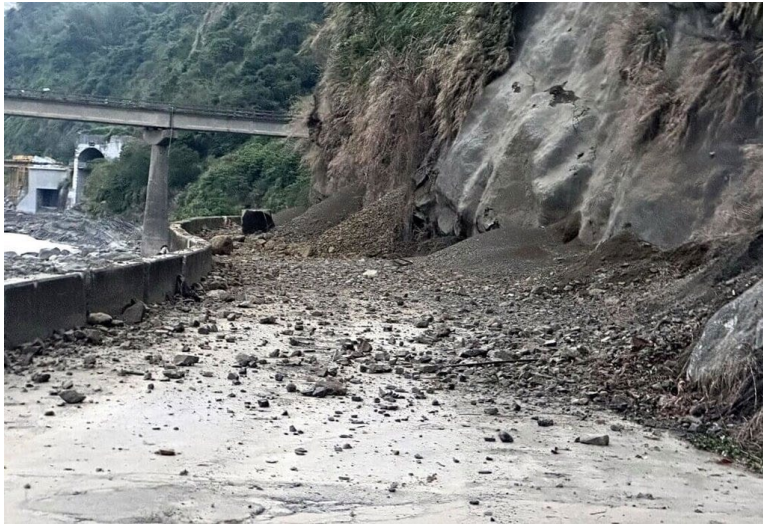
嘉義縣大埔鄉西興村第8鄰出入道路坍塌中斷(圖 / 中央社 / 嘉義縣政府提供)
