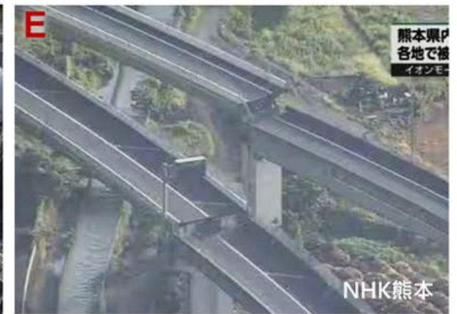
八代市內的高架道路發生錯位
