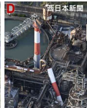
八代造紙工廠煙囪倒塌
