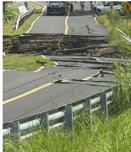
地震後於斷層沿線出現的可能斷層地表破裂, 與主震機制特性符合。(圖片來源: DMCAM / Geology Page, https://www.facebook.com/DMCAMontserrat/posts/-powerful-earthquake-strikes-panama-a-reminder-to-be-prepared-a-powerful-magnitud/1540229901470198/ )
